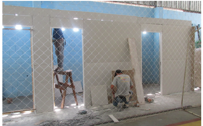
Estoque da unidade localizada na Vila Taubaté, projeto Ascenty realizado em 2015
